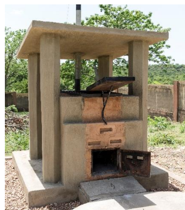
Dies ist ein Incinerator, eine Verbrennungsanlage für infektiöser Abfall.
